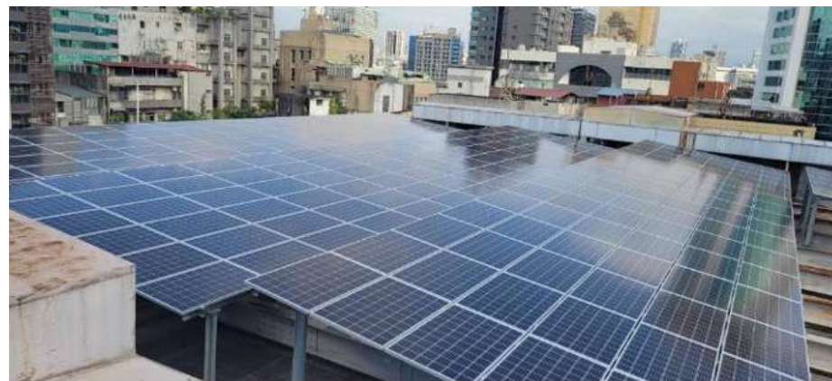
行舍頂樓設置之太陽能光電發電設備
